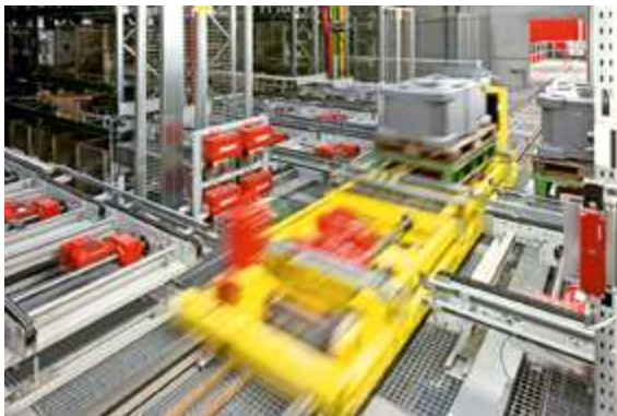
Hohe Dynamik in der Einlagerung durch effiziente Steuerung der Verschiebewägen
